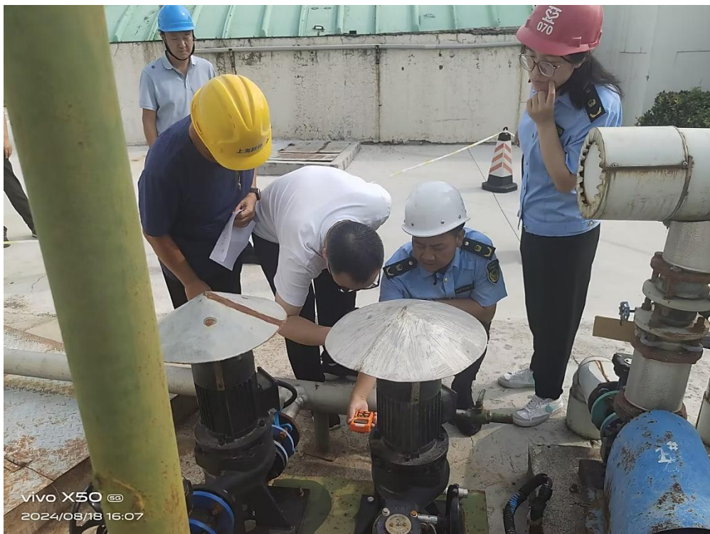
图 9 污泥回流泵区域现场有害气体检测
